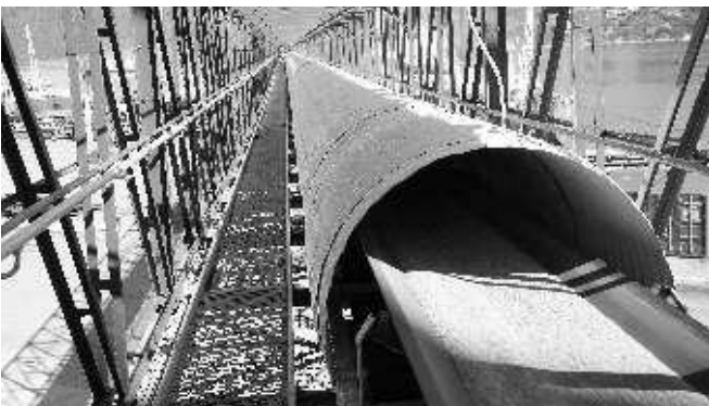
Transportador de correia em passarela metálica
