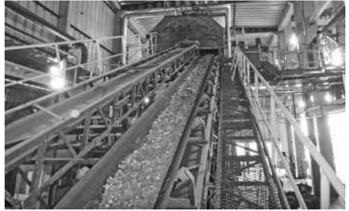
Transportador de correia para alimentação de caldeira
