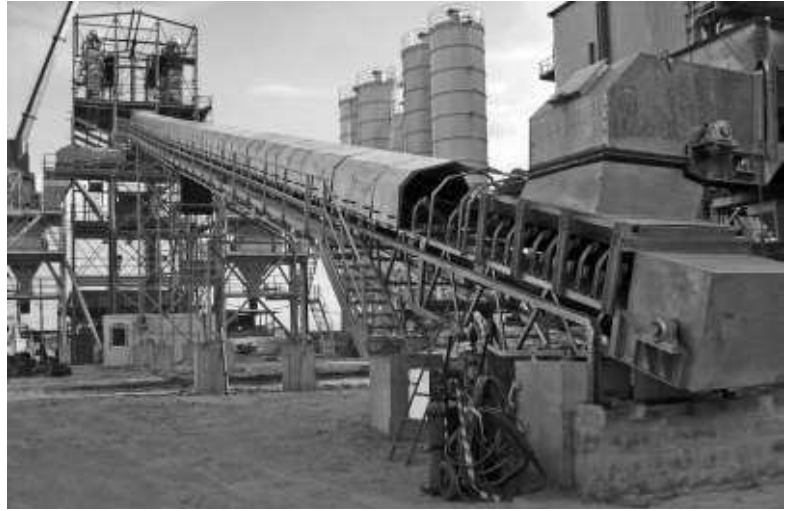
Transportador de correia com cobertura
